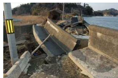
津波で崩壊した堤防（手樽）
