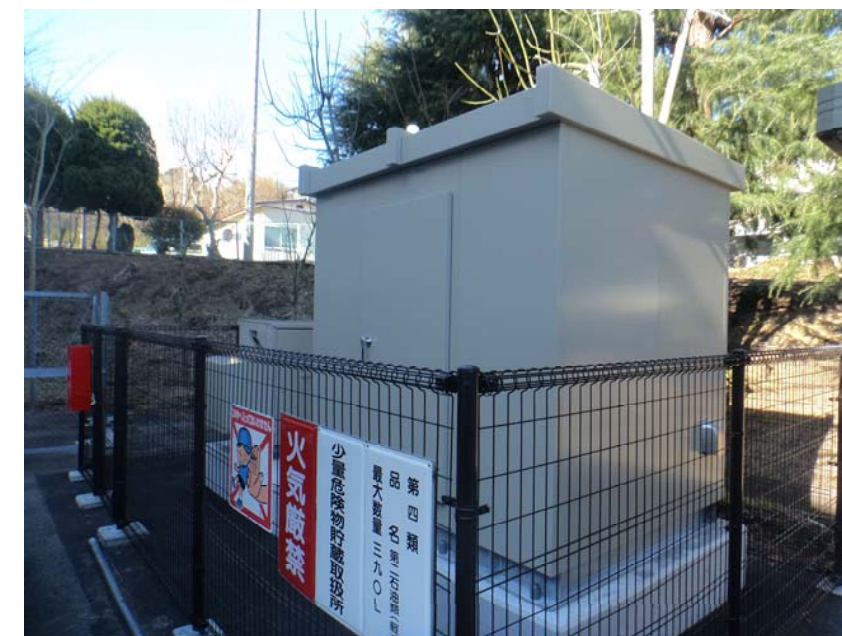
■自家発電設備（松島第一小学校）
