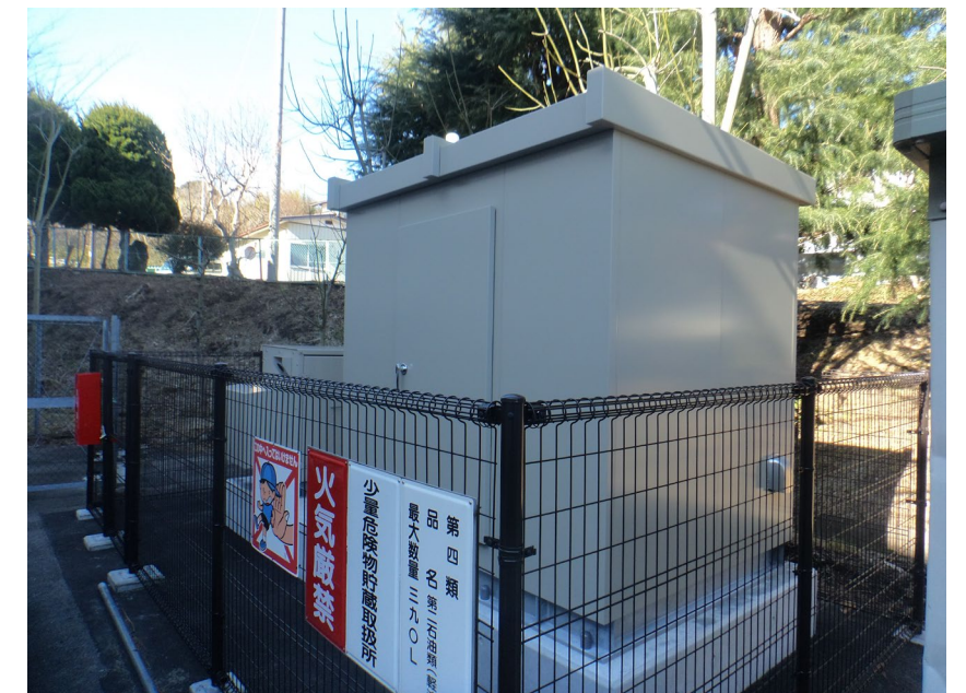
■自家発電設備（松島第一小学校）
