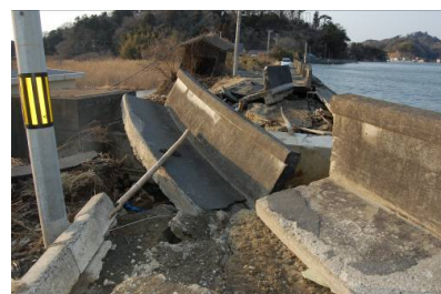
津波で崩壊した堤防（手樽）
