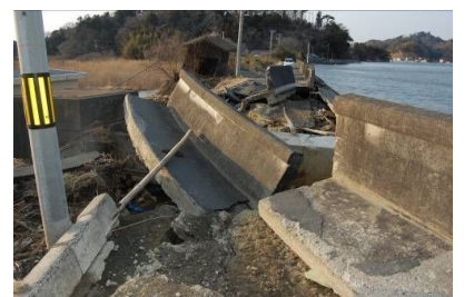
津波で崩壊した堤防(手樽)
