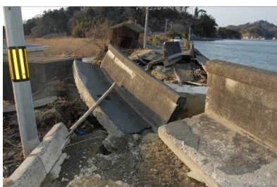
津波で崩壊した堤防（手樽）
