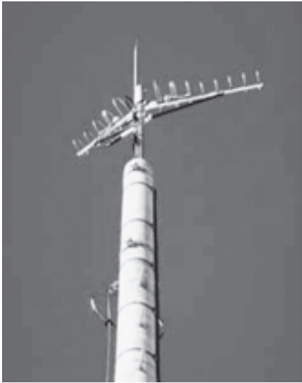
松島海岸・初原・反町地区に 7基設置されるギャップファイラー
