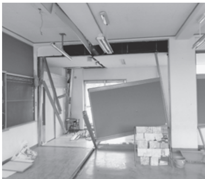
松一小校舎被災状況
