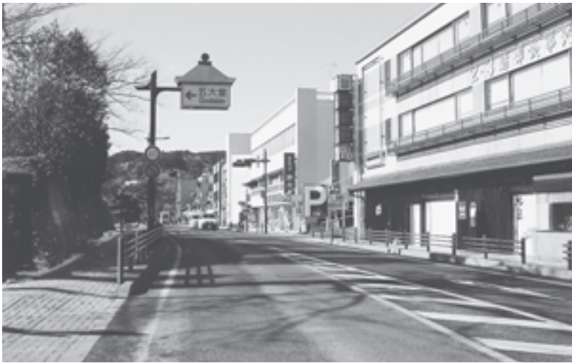
歩道の拡幅を機に大口径の排水用のマンホールが埋設される国道45号
