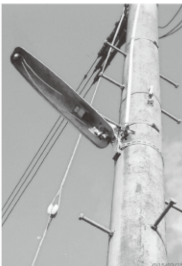
壊れた防犯灯
