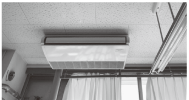
各町立学校に設置されたエアコン
