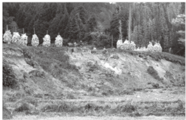
台風第19号被災の様子(雁ヶ沢地区)
