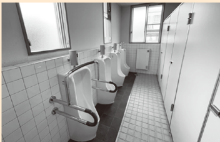
品井沼農村環境改善センター 品井沼農村環境改善センタートイレ等 改修工事(産業観光課)
