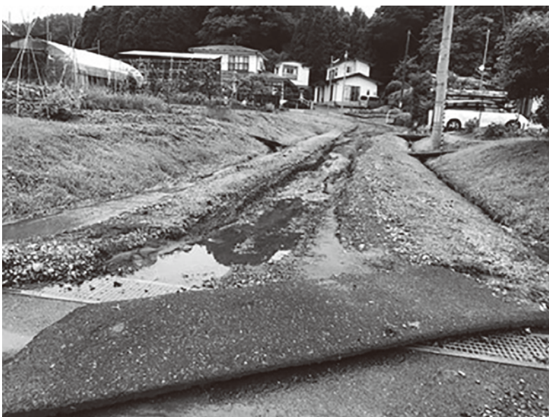
反町地区での道路被害
