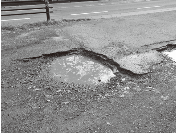
当時の陥没の様子
