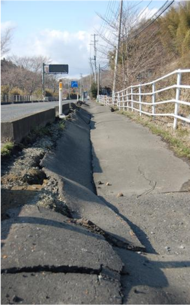
17. 沈下した根廻地区の歩道（国道346号）
