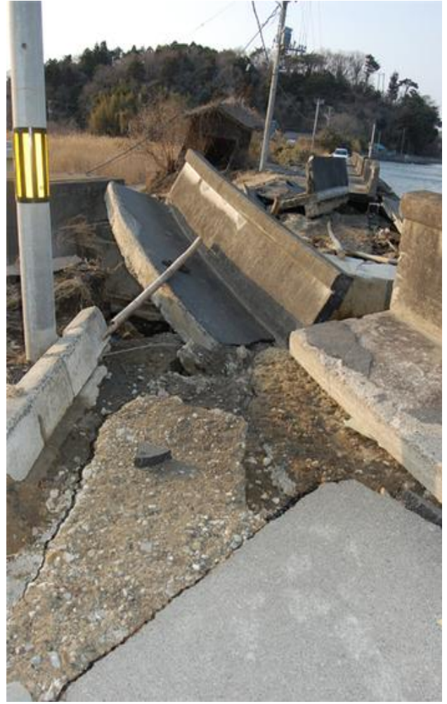
18. 津波で崩壊した堤防（手樽新駒形配水機場）
