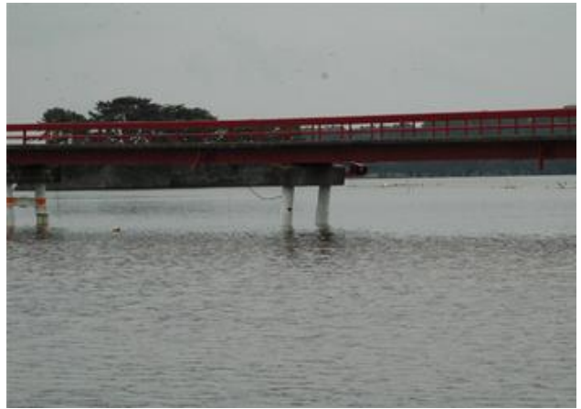
20. 橋脚が曲がった福浦橋
