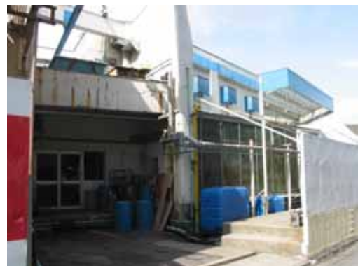
建物は老朽化に加え塩害の影響が著しい
