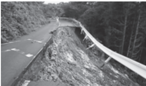
▲町道のパノラマ線の崩落状況
