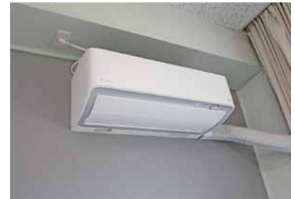
▲本町在住の熊谷直彦様他6名様より、第一小学校と第二小学校通級教室にエアコンを設置していただきました。
